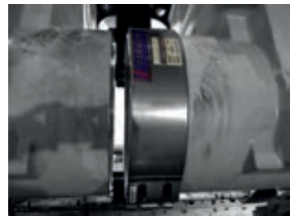
Rohrverbindung in einer Industrieanlage.
